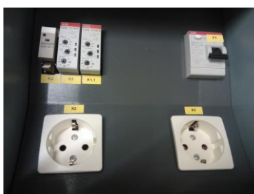
Bild från insidan av IISI S6/S10 PRO elcentralen
