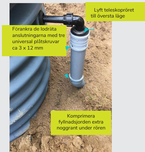
Bild 15: Anslutning av avloppsrør for utgående renat vatten.
